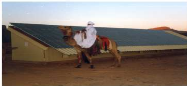
Fig. A.III.1: Système photovoltaïque de puissance 6 [kWc] installé au village isolé de Terhenanet- wilaya de Tamanrasset
