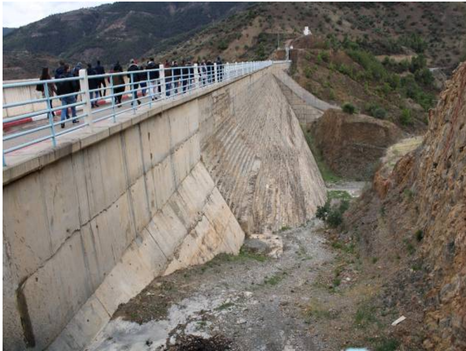
Figure 14. Digue principale du barrage poids, type Béton Compacté au Rouleau (BCR) – Vue aval [photo Lyes].
