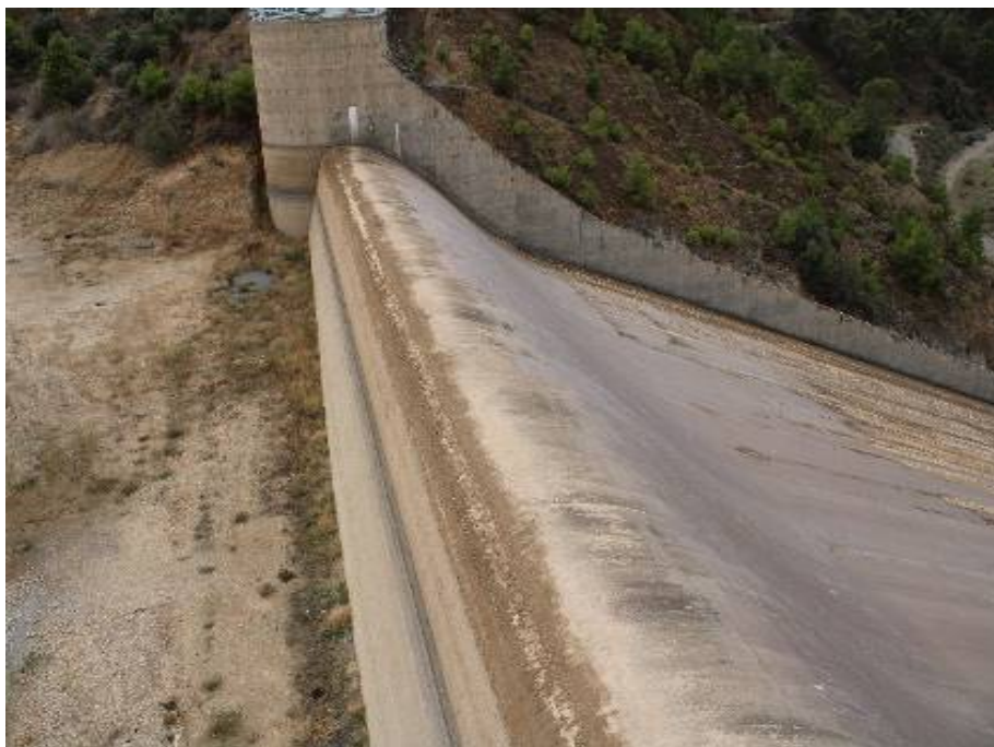
Figure 15. Déversoir d'évacuateur de crues principal à seuil libre (type Creager) [photo Lyes].
