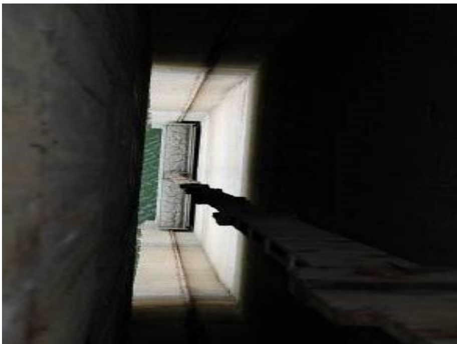
Figure 19. Vue de dessus de la vanne de vidange de fond [photo Lyes].
