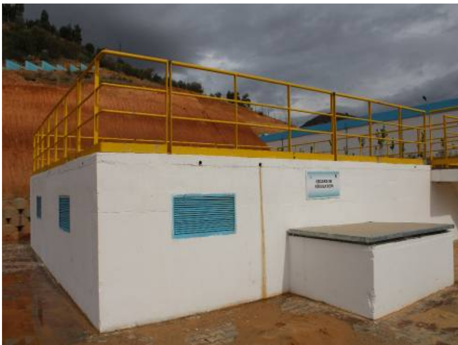
Figure 28. Ouvrage de régulation.
