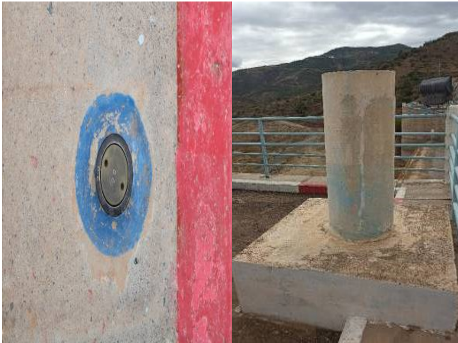
Figure 18. Point de mesure géodésique pour l'auscultation, surveillance de la sécurité du barrage [photo Slimani].
