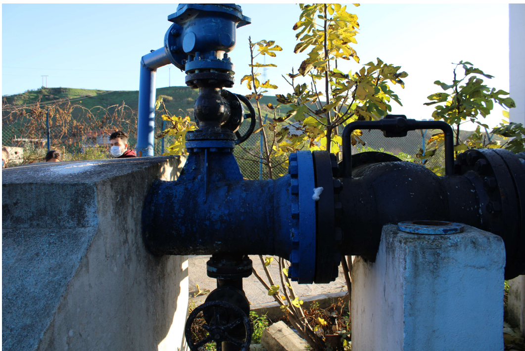
Figure 8. Soupape de décharge et vanne anti retour (Photo Beldjerd).
