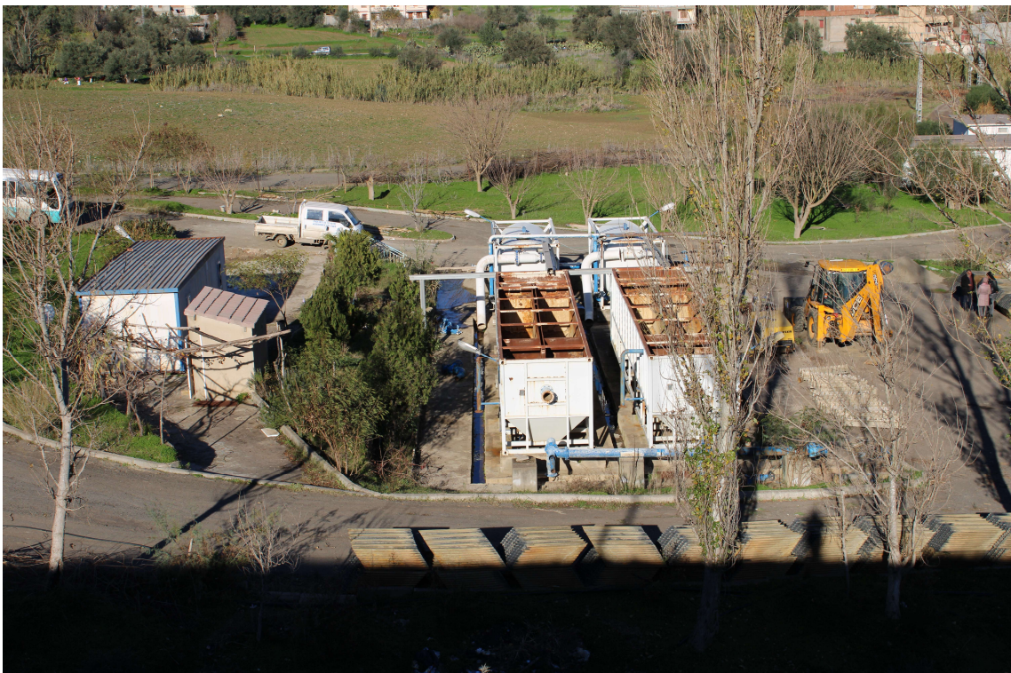
Figure 28. Vue d'ensemble de la station de traitement du barrage Tizi Ghenif (Photo Beldjerd).
