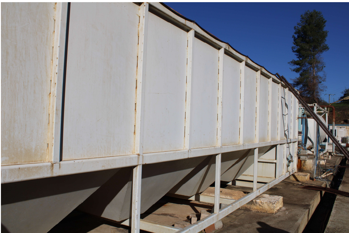
Figure 17. Le compartiment de décantation de la station de traitement (Photo Beldjerd).
