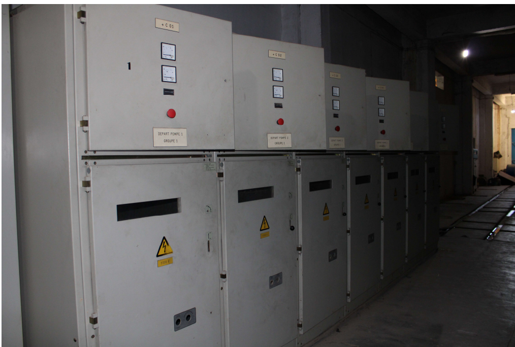
Figure 6. Armoires électriques (Photo Beldjerd).
