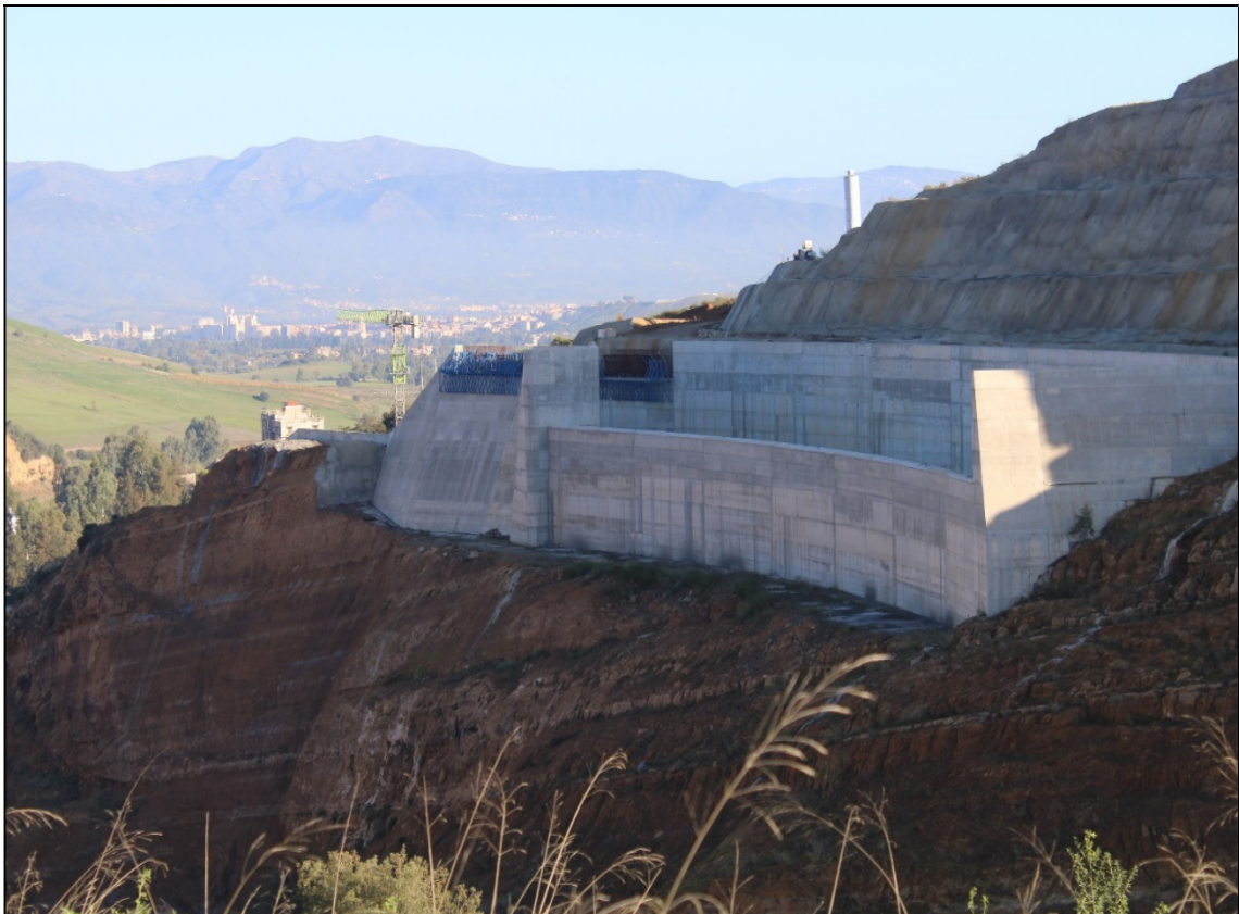
Figure 9. Vue de l'évacuateur à entonnement frontal en béton en cours de réalisation (Photo Beldjerd).
