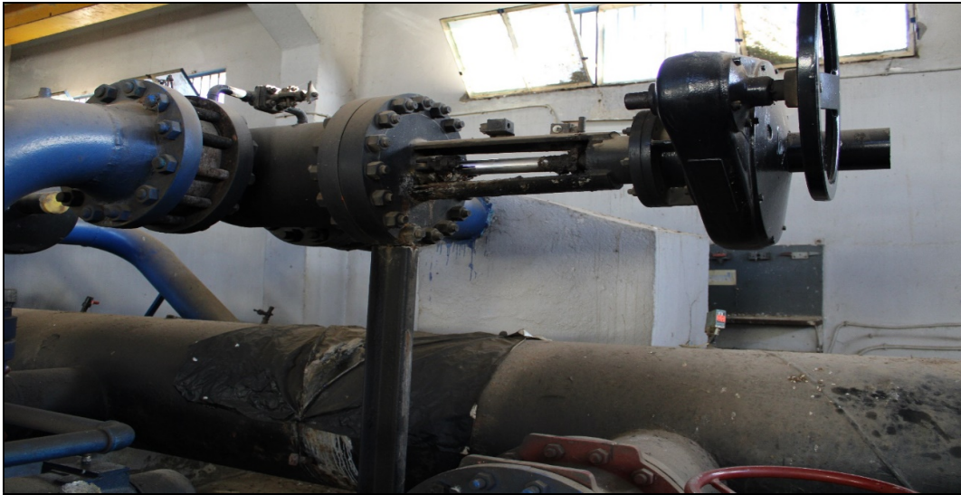
Figure 3. Vanne de sectionnement à volant (Photo Beldjerd).
