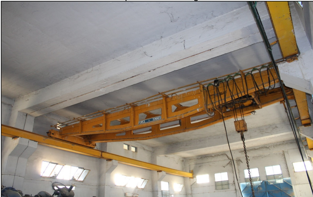
Figure 4. Pont roulant de capacité 8 tonnes (Photo Beldjerd).
