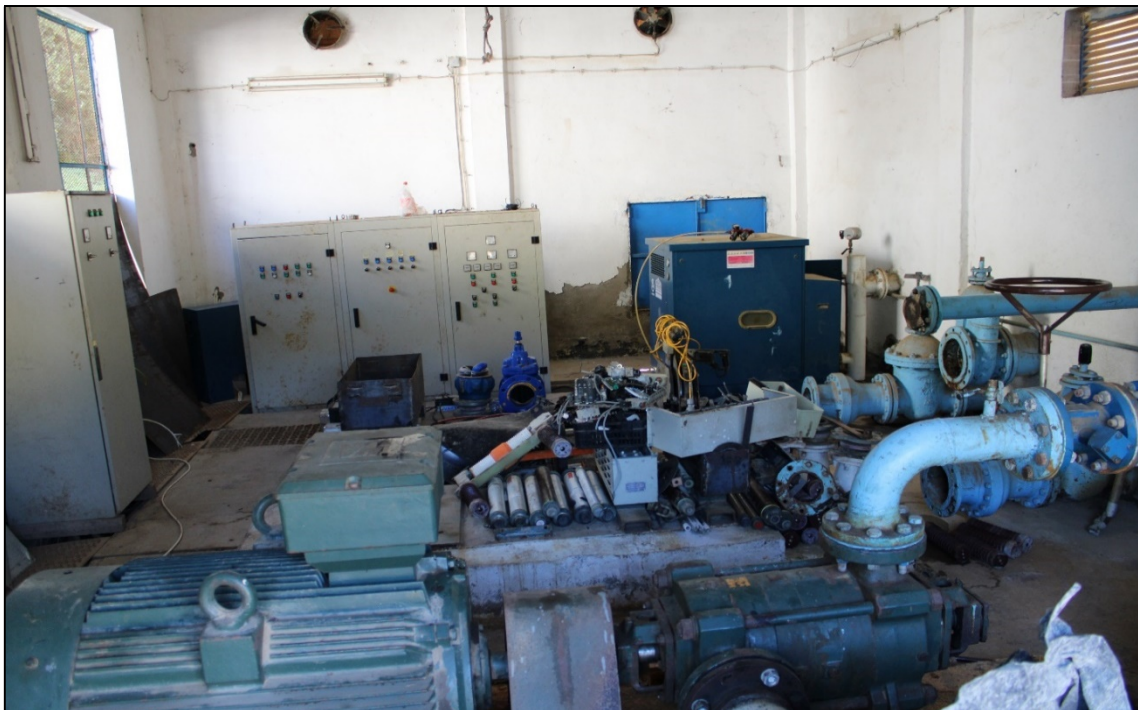
Figure 19. Station de refoulement de l'eau traitée (Photo Beldjerd).
